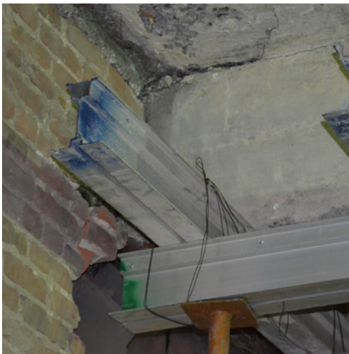
Détérioration du jambage de maçonnerie de l'une des fenêtres sous la pression d'une poutre d'acier.
