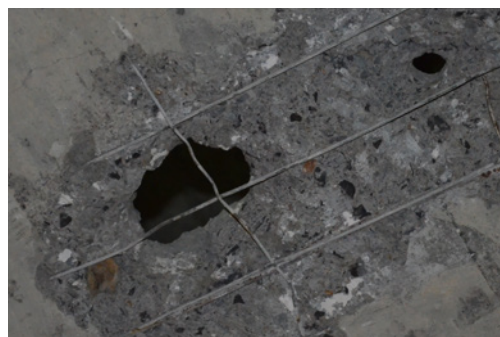
Dalle percée et treillis d'armature apparent.
