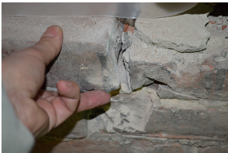
En plusieurs endroits sous les fenêtres le mortier n'a aucune cohésion.
