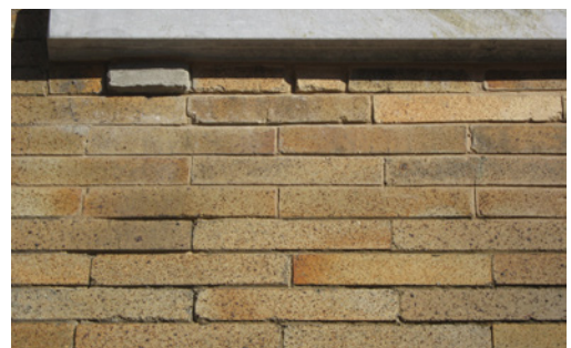
Joints évidés sous l'allège de pierre des fenêtres.
