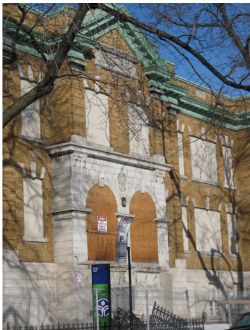
Entrée principale de l'école : l'escalier d'accès monumental a disparu et doit être remplacé.
