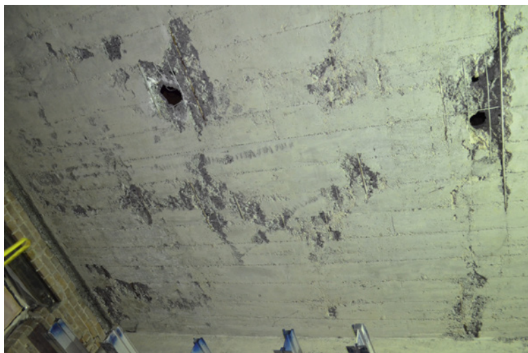
Dégradation de l'intrados de la dalle de béton dans l'aile est de l'école.
